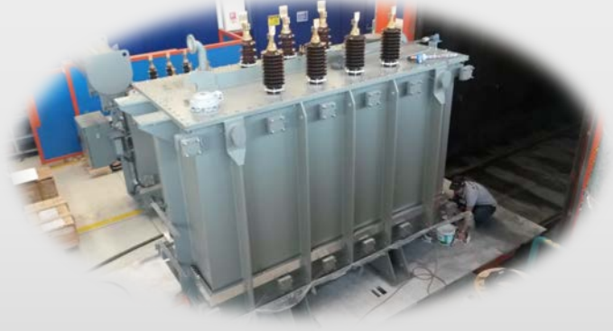
35 MVA, 34,5/11 kV ÇELİKLER HOLDİNG PROJESİ
