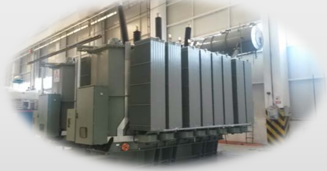
100 MVA, 154/33,6 kV TRANSFORMATÖRÜ
