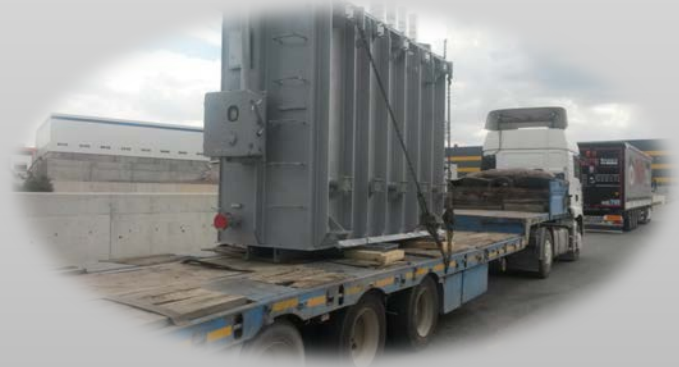
20 MVA GEDİZ EDAŞ TRANSFORMATÖRÜ
