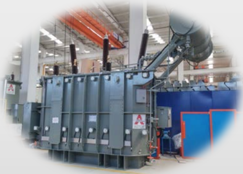
62,5 MVA, 154/33,6 kV TRANSFORMATÖRÜ
