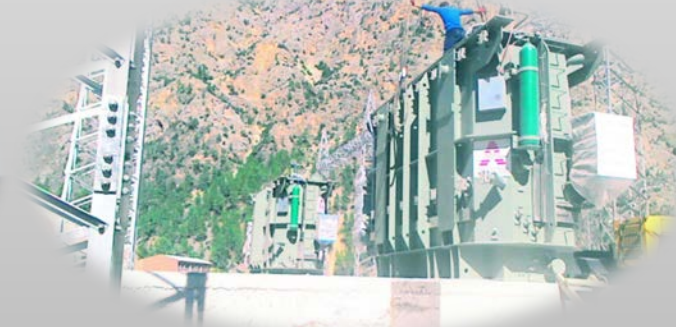
62,5 MVA, 154/33,6 kV DARAN-HAVZA TRAFİKO MERKEZİ
